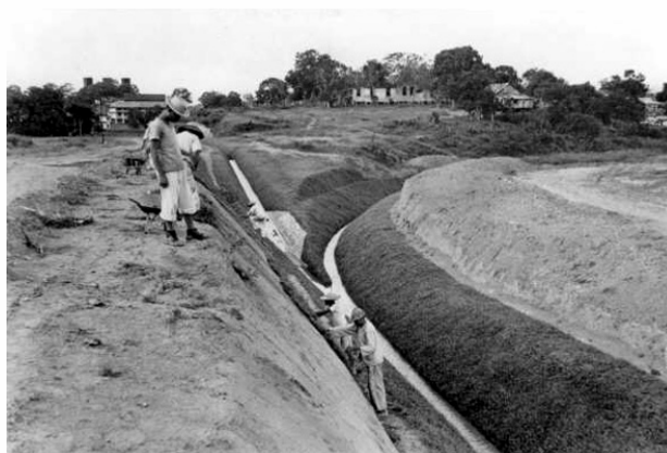
Imagem 29 - FISHER, Alan. Obra de drenagem e controle da malária. Porto Velho (RO), entre 1944 e 1946. Arquivo Fundação Serviços de Saúde Pública, Casa de Oswaldo Cruz/Fiocruz.
